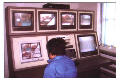
电视监控系统
