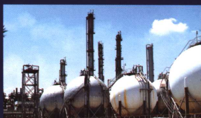
公司炼油化工事业部乙烯装置球罐区
