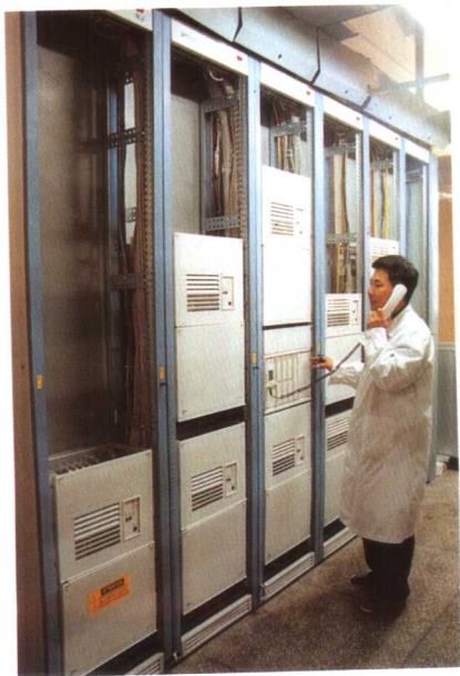
► 京九广缆开封分路站
