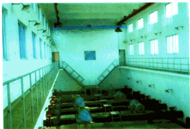
日供水能力5万吨的第二水厂泵房
