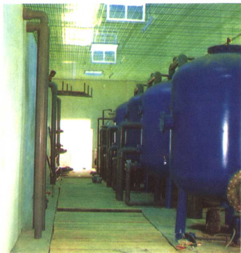
工厂化养鱼 水处理设施
