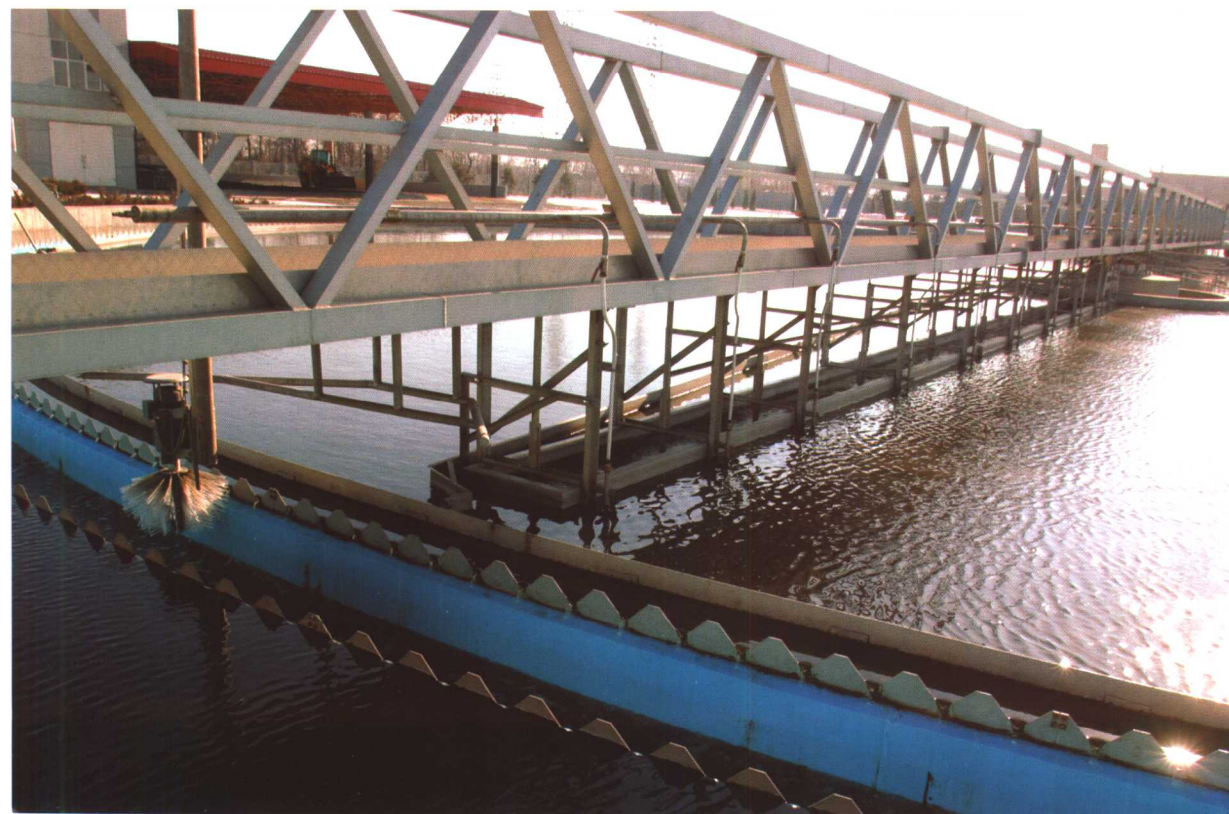
↓北京2008年奥运会的配套项目之一：威立雅北京卢沟桥污水处理项目
