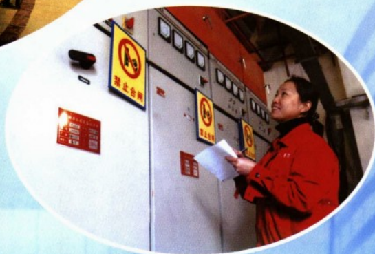
新疆广汇红十月小区集中供热自动化控制室
