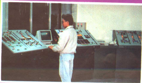
全自动控制室
