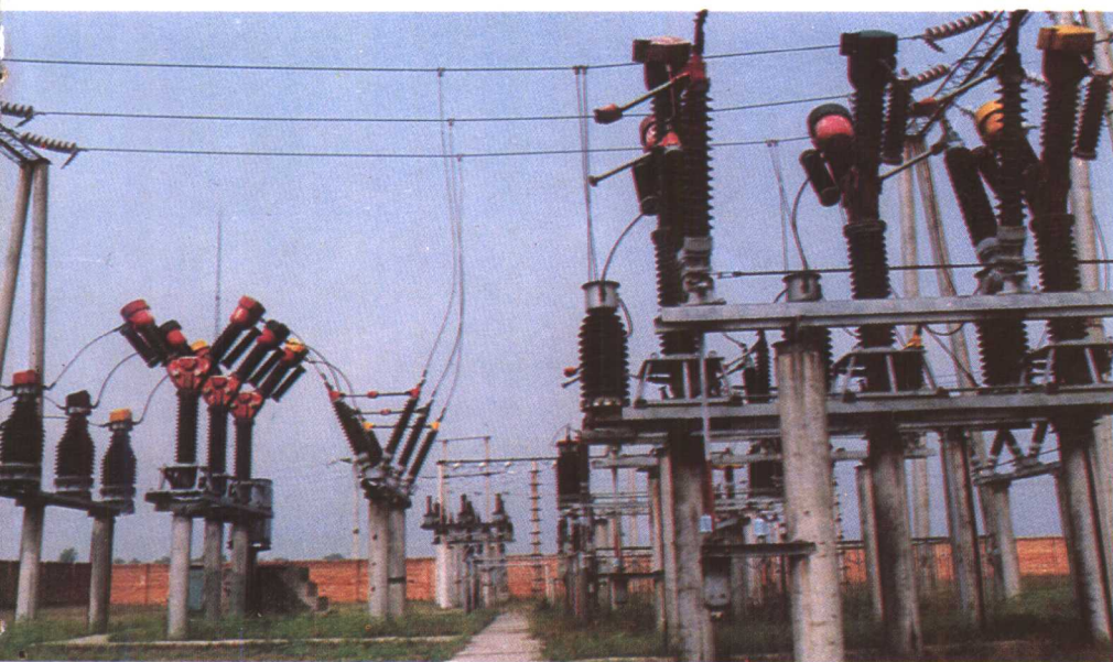
◀ 十一万伏变电站
