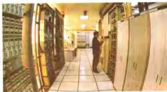
正在运行中的微波通信设备
