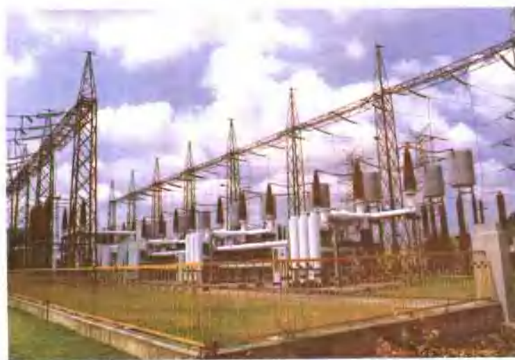
华能南通发电厂是省内第一个采用全封闭母线和开关 (GIS) 220 千伏升压站
