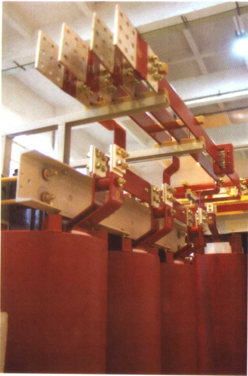
图 4-10 低压横排侧出线
