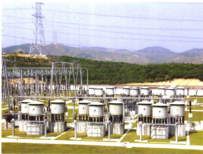
图5-2 在某500kV变电站运行的干式空心并联电抗器
