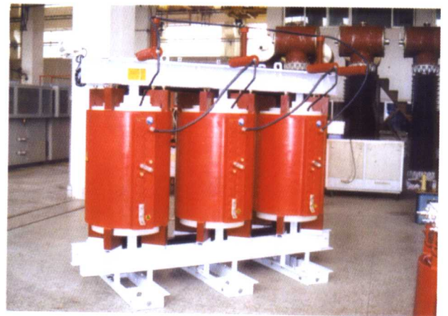
图 5-16 35kV 接地变压器
