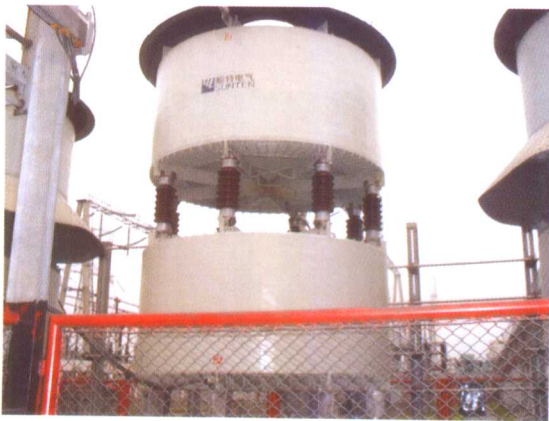
图5-19 运行中的35kV TCR干式空心并联电抗器
