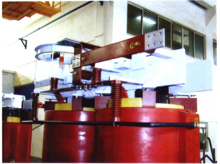
图 4-23 侧封闭母线出线
