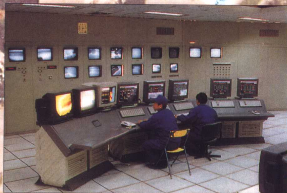
国投浮法示范线中央控制室
