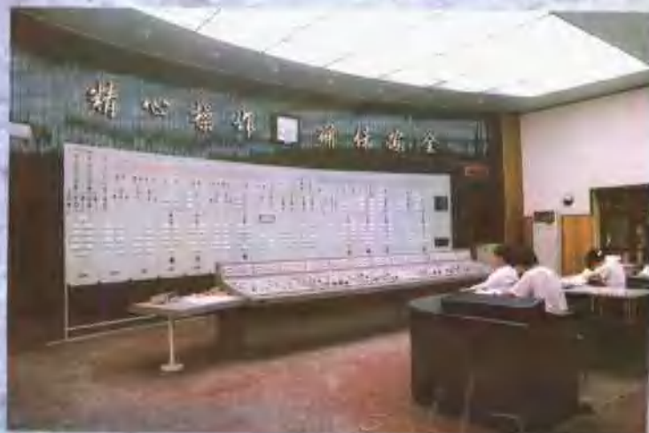
水电厂中央控制室
