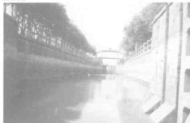
蕉桑联围顺德段龙江镇歌活水闸
