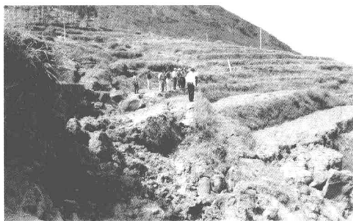
图 1.6 公路开挖引起的岩土体边坡滑坡
