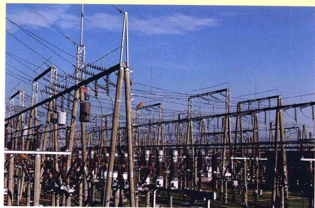
曲河220Kv变电站
