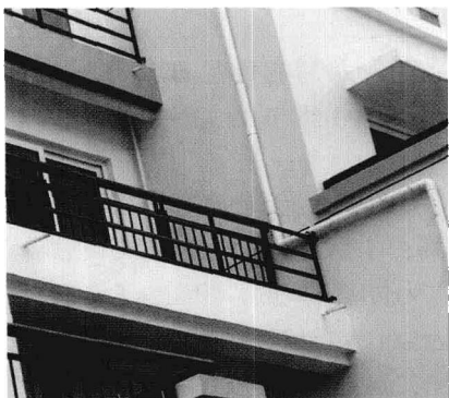
图1-2 上层花池排水，直接排到下层露台处，不得不后期修改管道
