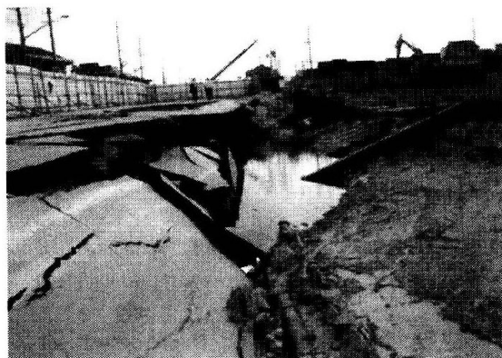
图 1-1 某基坑事故造成道路破坏
