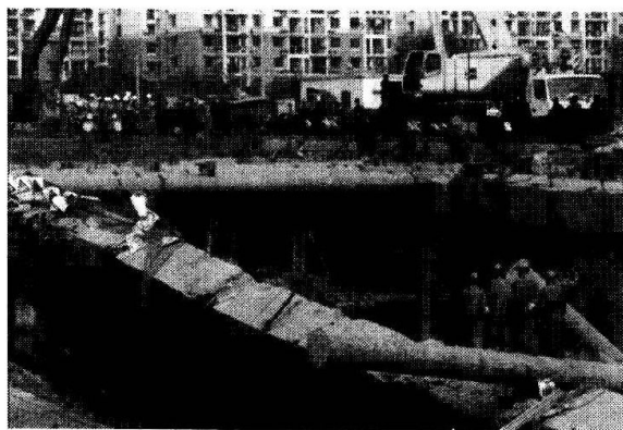
图 1-3 某基坑支护体系崩溃
