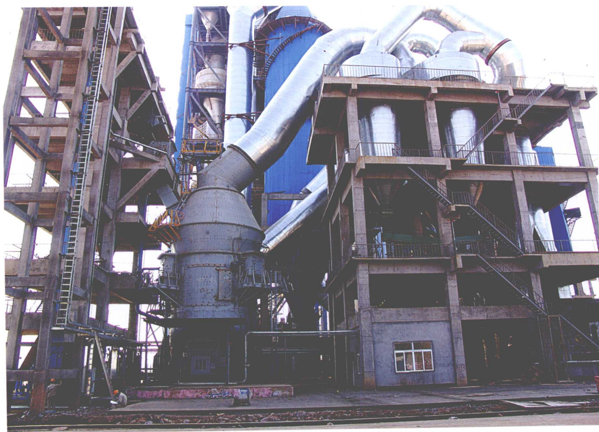
图为南方水泥有限公司引进的德国 pfeiffer 公司的 MPS5000B 辊式磨。
