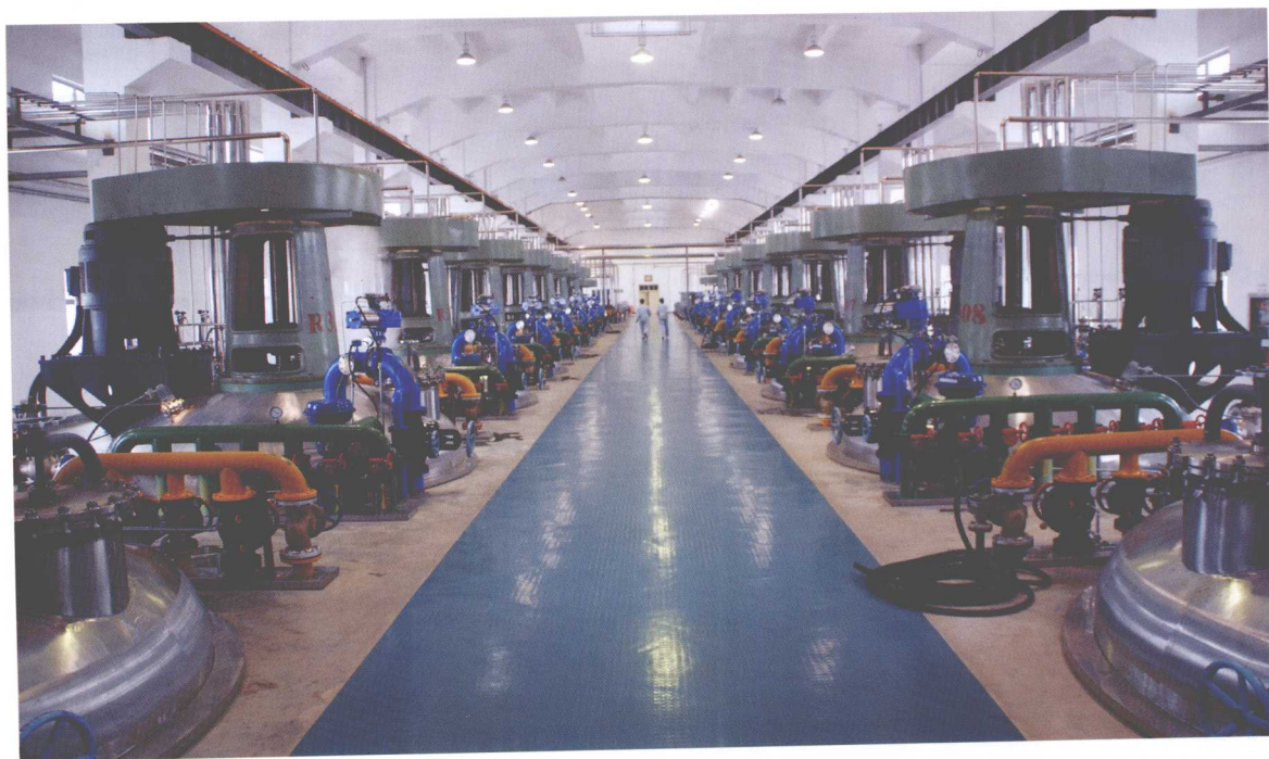
图为新昌制药厂生物制药车间。
