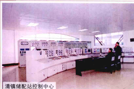
清镇储配站控制中心
