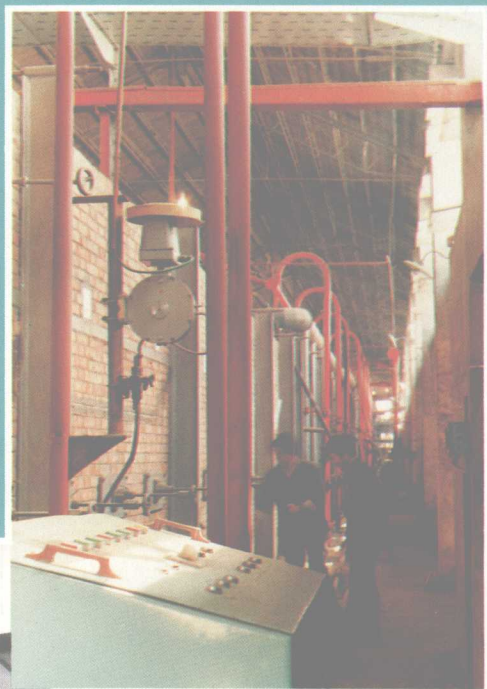
采用第四代能源的 焦化煤气隧道窑炉
