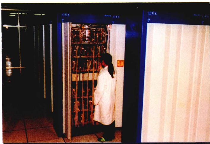
程控电话交换机房
