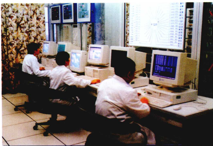
长途通信机房
