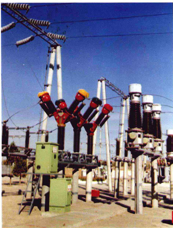
▲ 110千伏油坊变电站
