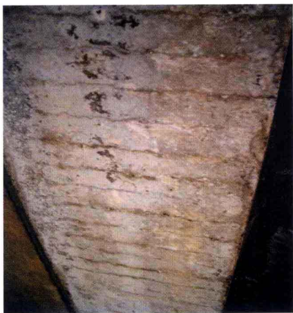
钢筋混凝土空心板底板横向裂缝
