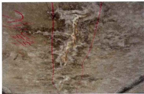
底板纵向裂缝渗水钙化
