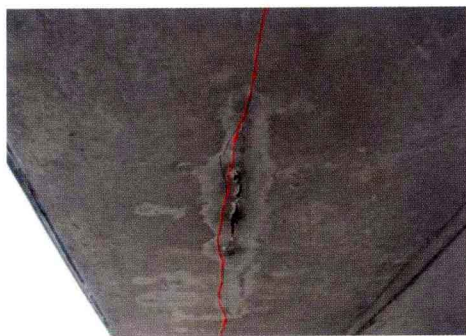
底板纵向裂缝渗水钙化
