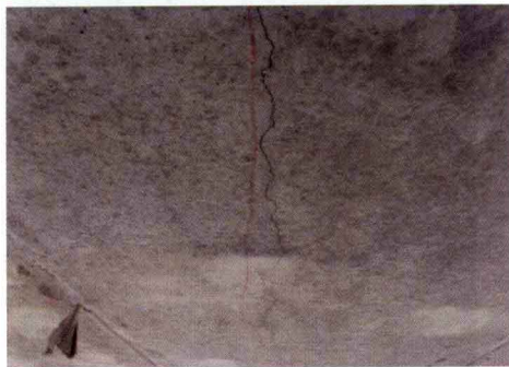
预应力混凝土空心板底板纵向裂缝
