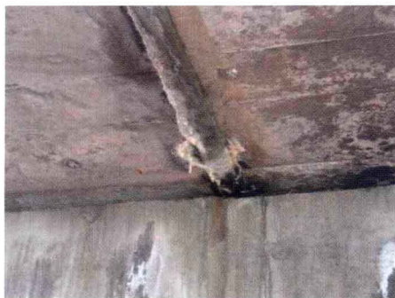
铰缝渗水钙化形成钟乳状悬挂物
