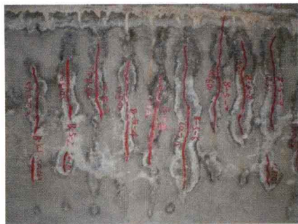
钢筋混凝土空心板底板渗水钙化
