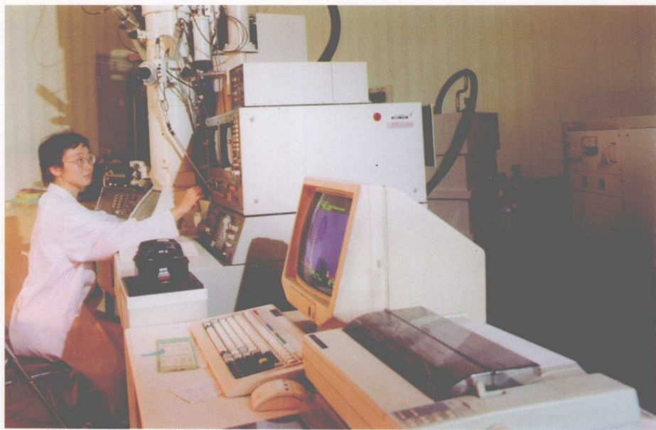
武钢扩建工程轧机主控室
