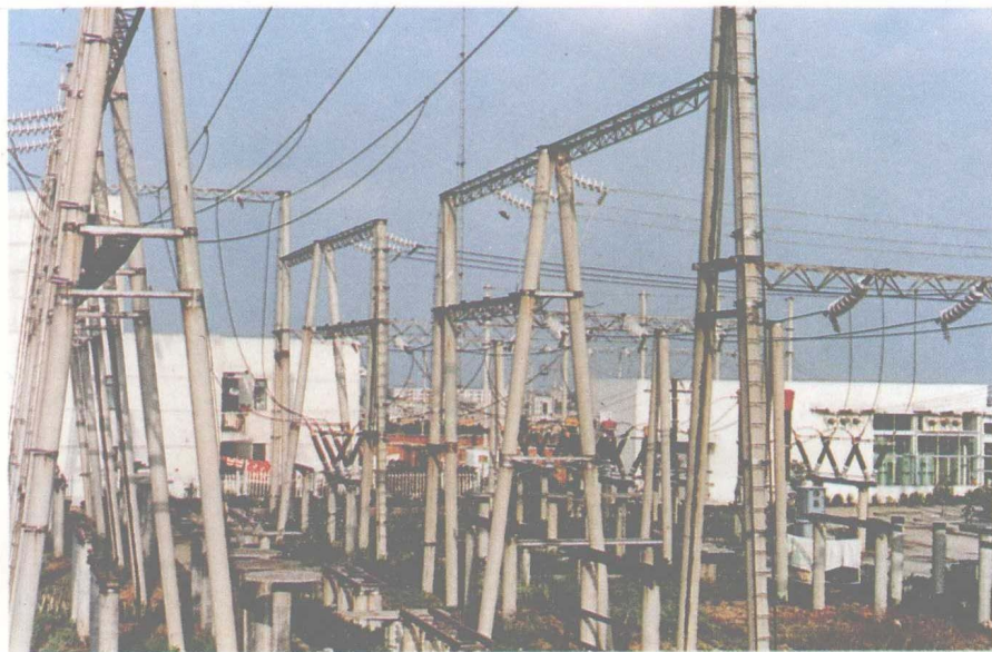
十一万伏变电站
