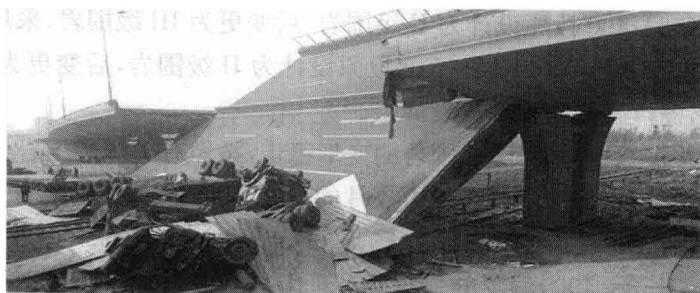
图 1-10 国内某桥发生倾斜事故
