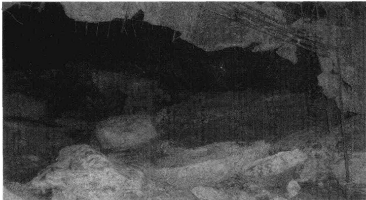
图 1-9 国内某隧道发生坍塌事故
