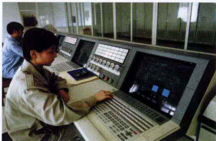
生产装置实现了DCS控制操作
