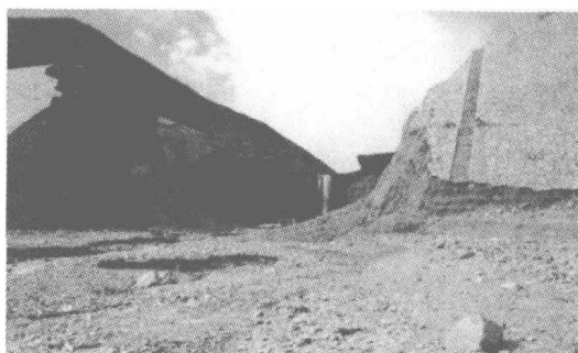
图 1.4 青海沟后水库溃口（1993）
