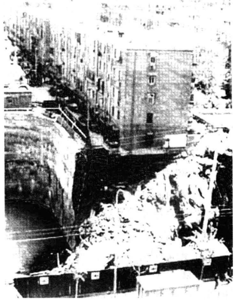
(b) 支护工程坍塌
