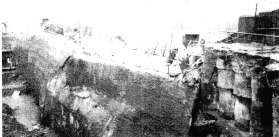
(d) 支护结构大量坍塌
