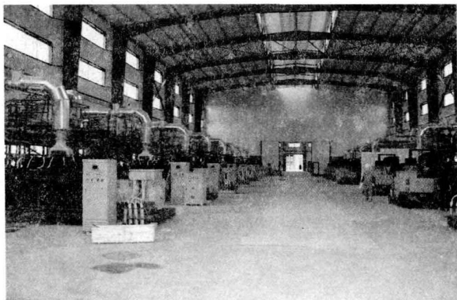
西露天矿坑口油厂瓦斯发电机组竣工验收场景
