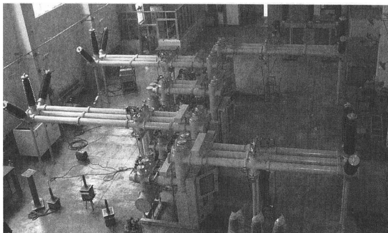
图 2-2 GIS 设备在变电站的应用
