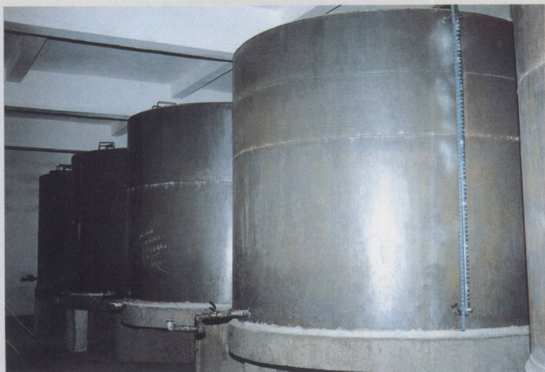
文昌产油基地县20世纪80年代建造的大型储油罐
