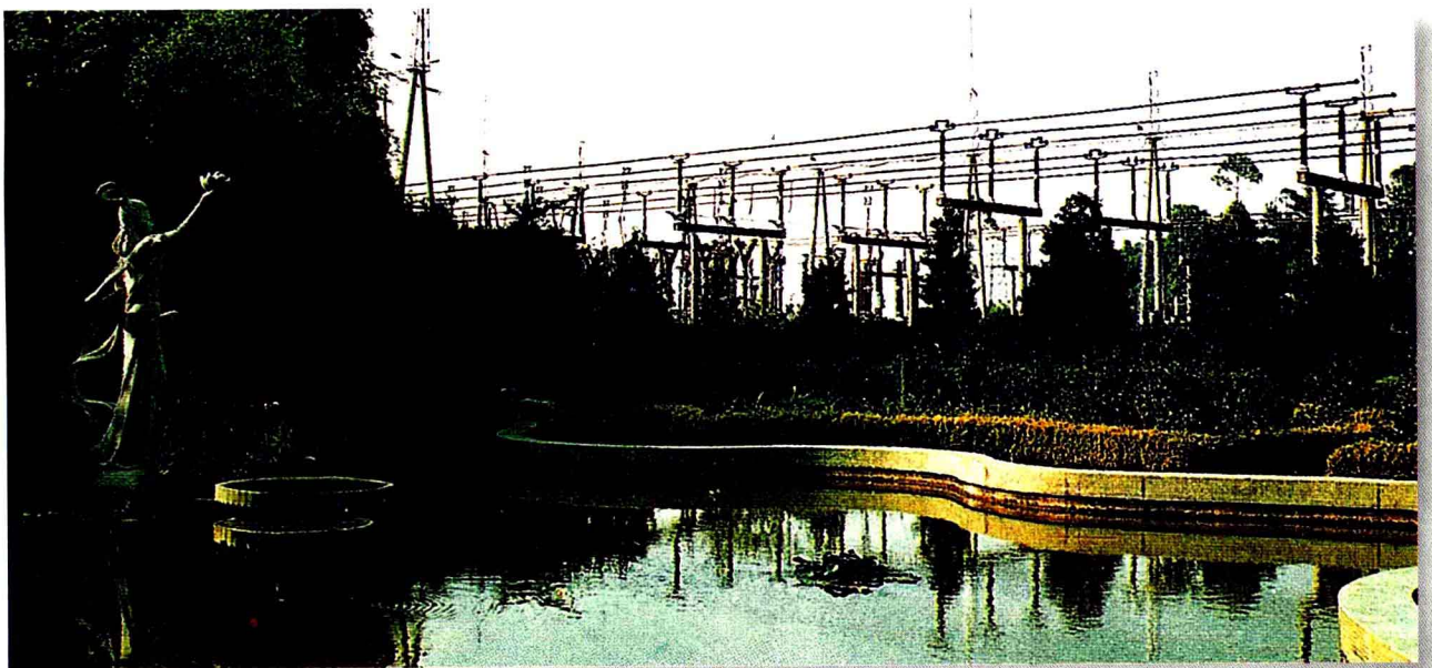
泸州地区最大的变电站——220千伏林庄变电站
