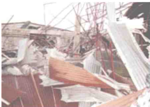
3月29日下午3时50分左右，雷雨大风袭击深圳市龙岗区，造成5人死亡，多人受伤。图为被大风洗劫的厂房。
