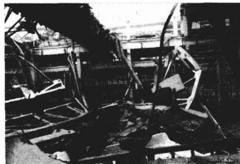
图 1.14 东汽单层厂房构件连接不牢倒塌
