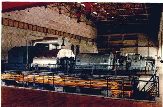
马村电厂（一、二、三期工程及送出工程）
