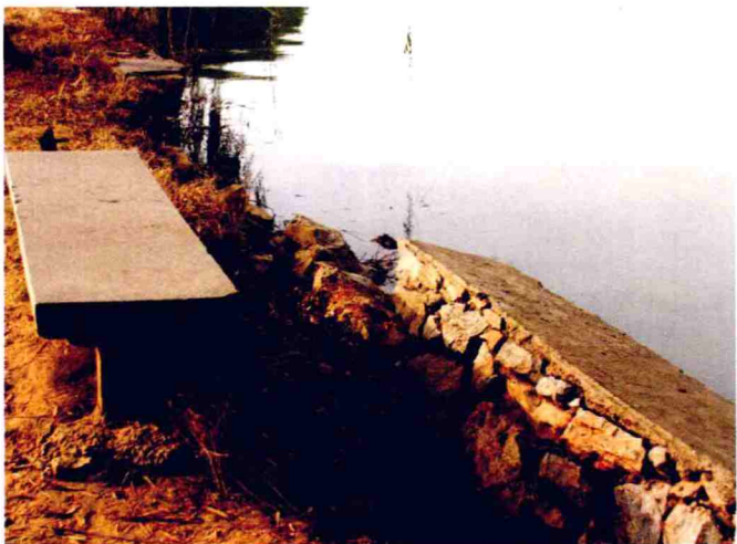
12 由于护底不够,岸底泥沙受到长期冲刷,致使护岸倾斜、垮塌
