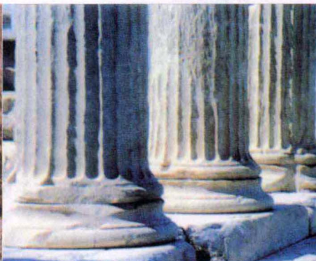
图1-2-13 被酸雨腐蚀的建筑物
