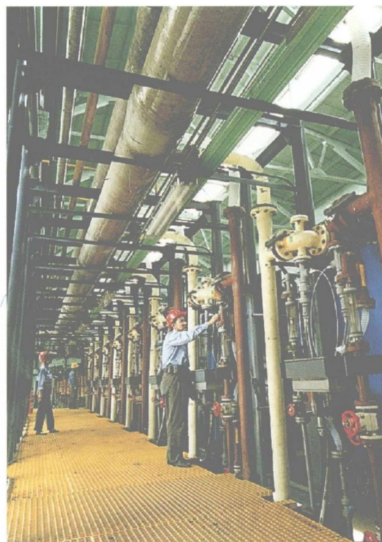
天原集团烧碱车间
