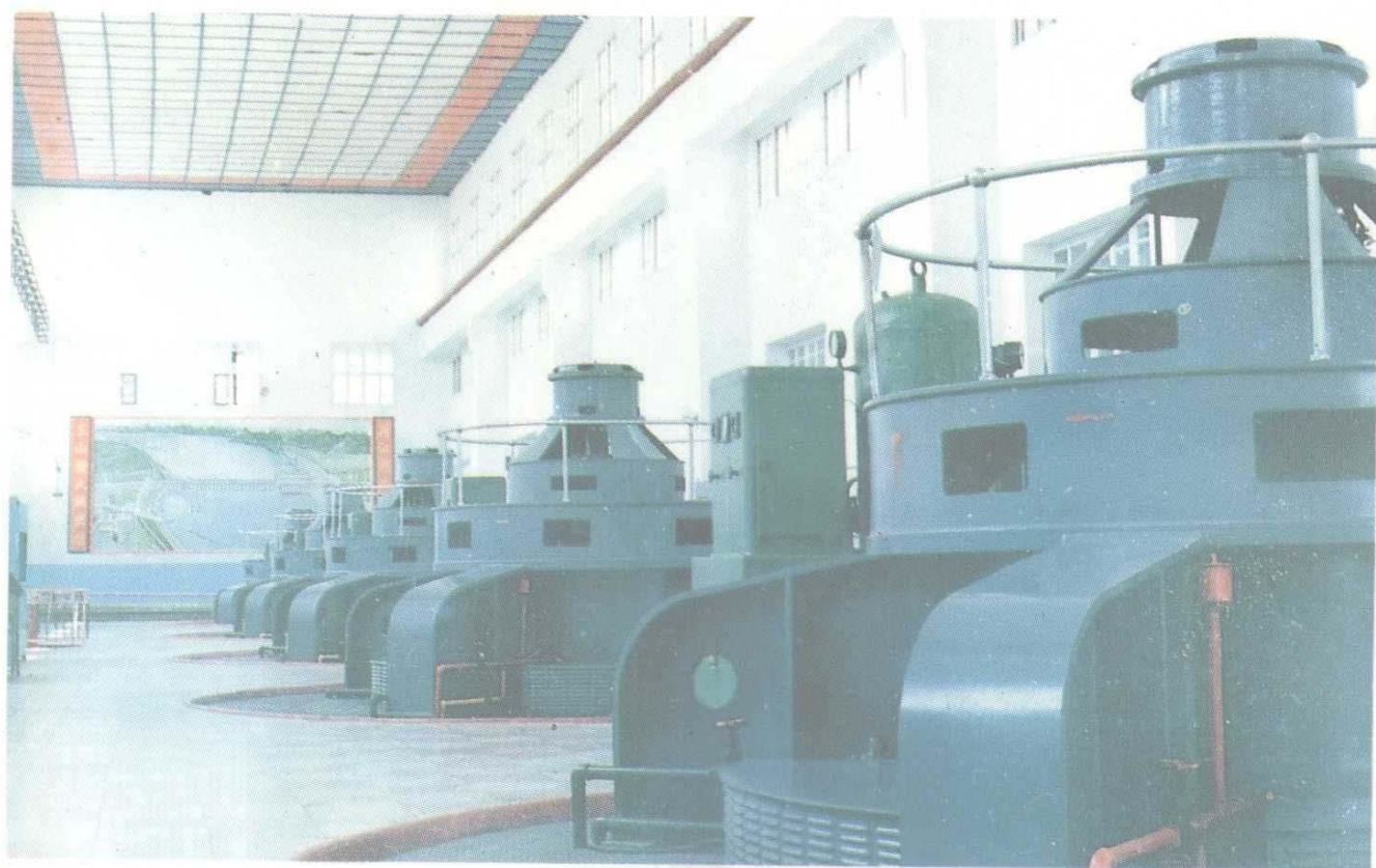
洋塘水轮泵水电站发电机房
