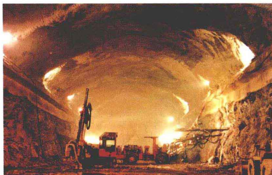
浙江天荒坪抽水蓄能电站地下厂房
