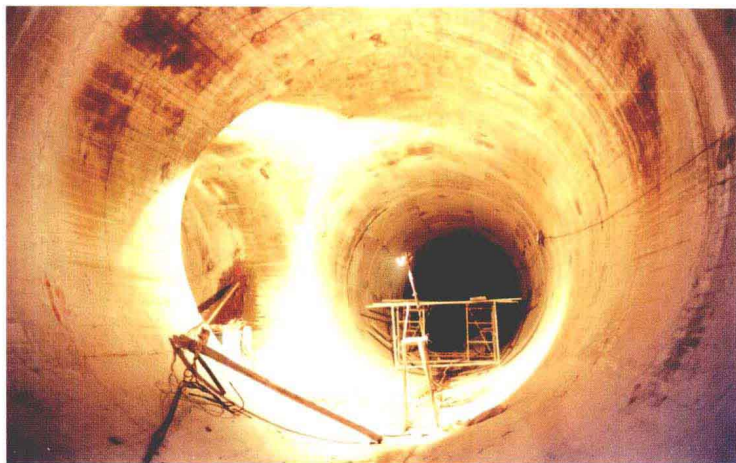
广东广州抽水蓄能电站高压岔管
