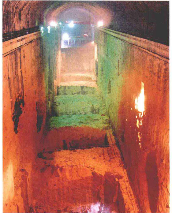
长江三峡水利枢纽工程右岸地下电站厂房
