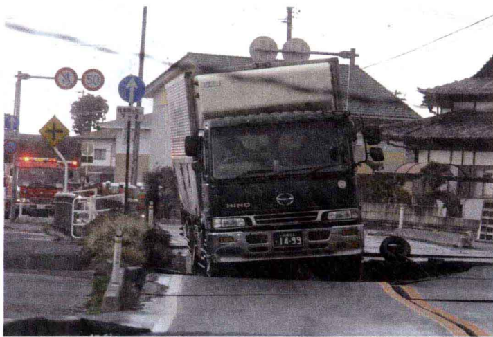
2011 年 3 月 11 日,日本东北部城市福岛县发生地震后,一辆卡车陷入道路的裂缝中。
