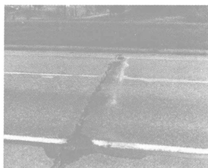
(l) 基层翘曲拱胀引起的裂缝
