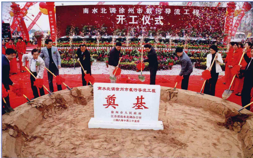
■ 2008年10月，南水北调东线一期工程江苏省徐州市截污导流工程开工建设。 (江苏省南水北调办 供稿)
