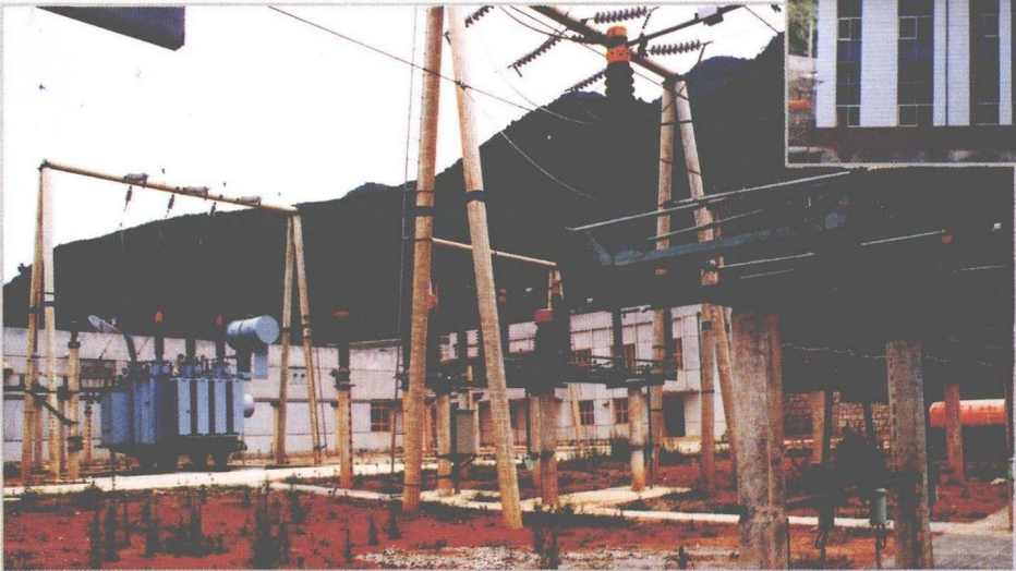
县供电变电站
