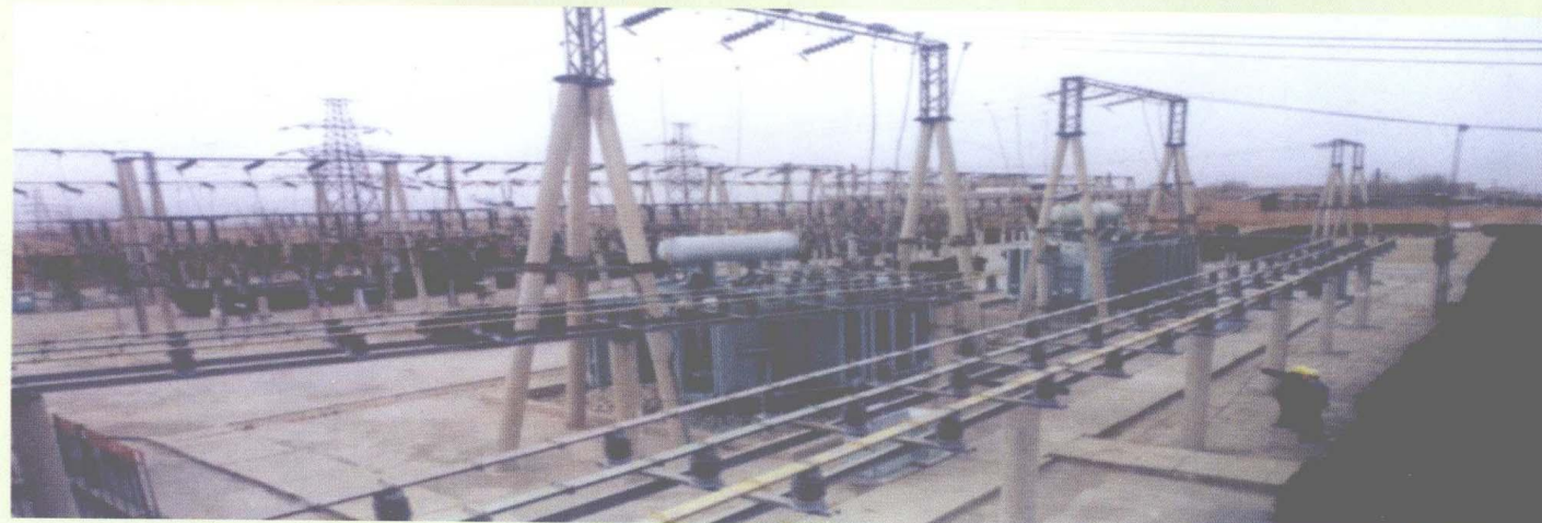
华北电网怀来县十万千伏变电站
