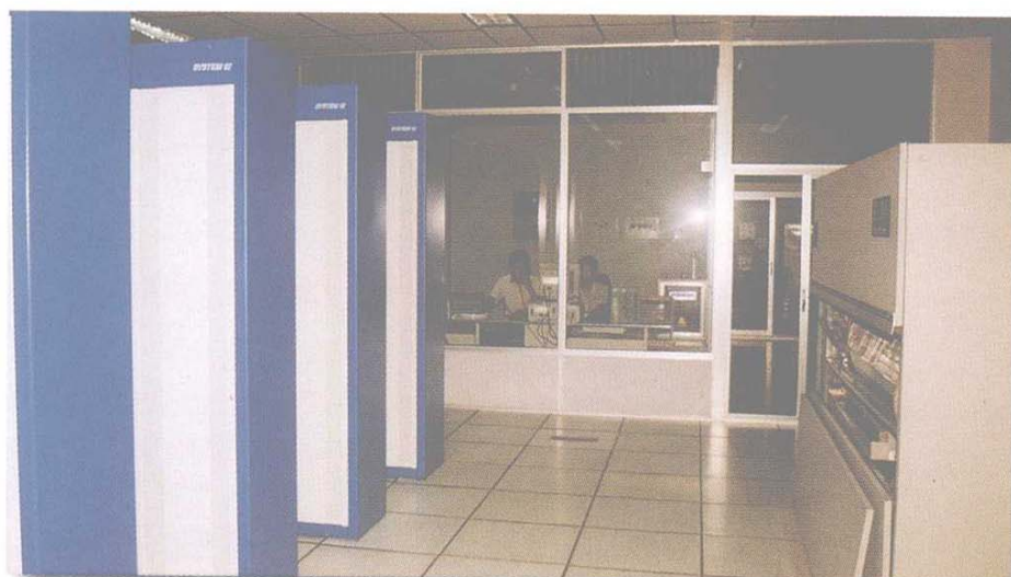
项城邮电局程控机房
