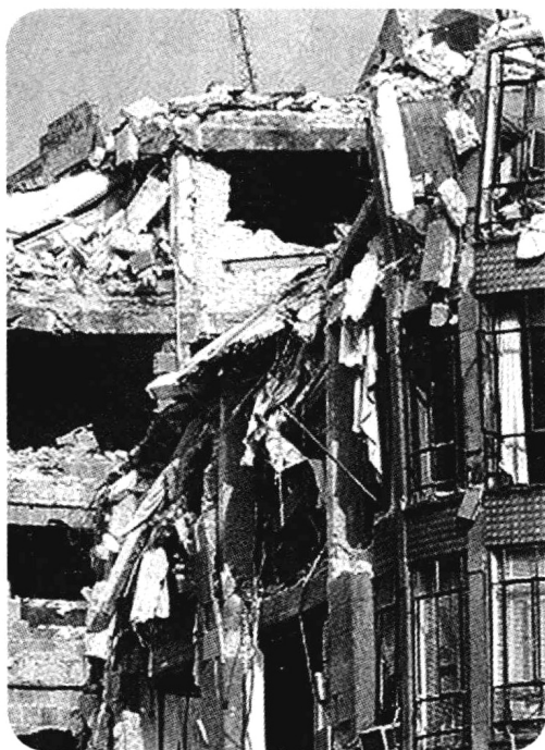
◆ 地震造成的房屋破坏
