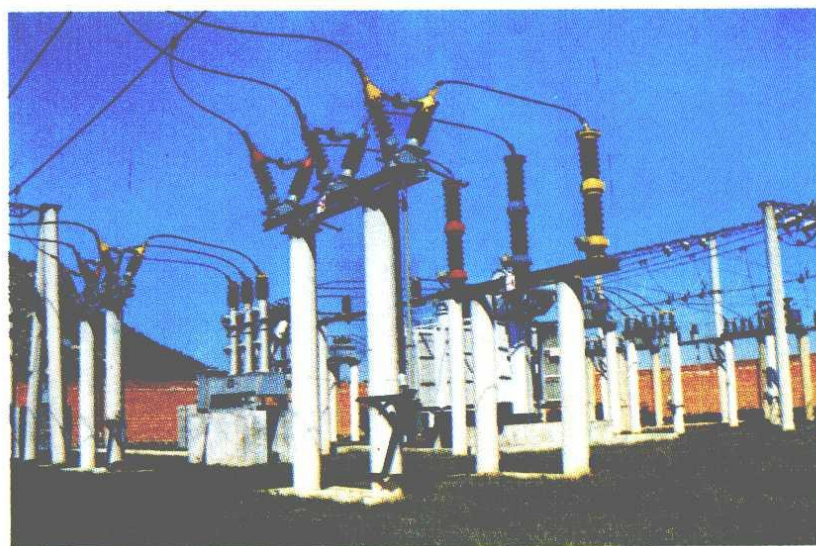
韩麻营 35 千伏变电站
