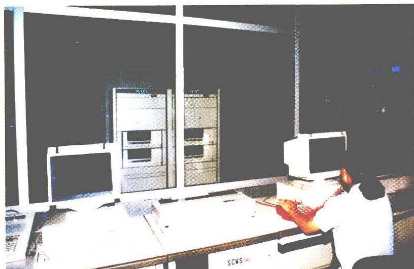
县电信局程控机房
